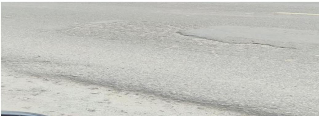
Gambar 1 : Kerusakan Pelepasan Butir
