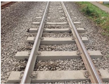
Gambar 0.3 Mud Pumping lintas Bekasi-Cikampek (Sumber : Survei Lapangan)
